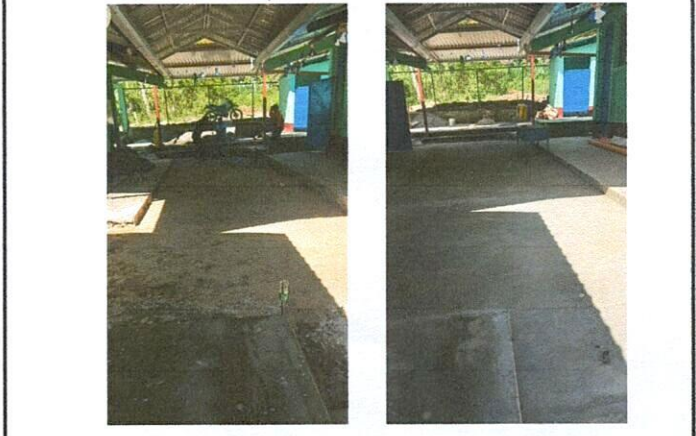
Foto 4: Necesidad de repación de losa de patio
